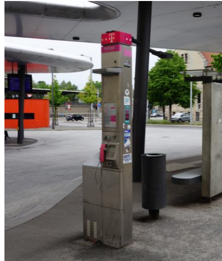
Kleinzelle outdoor (Mikrozelle) Bis einige 100 m Abdeckung Rundstrahlend oder gerichtet Antennendiagramm statisch
